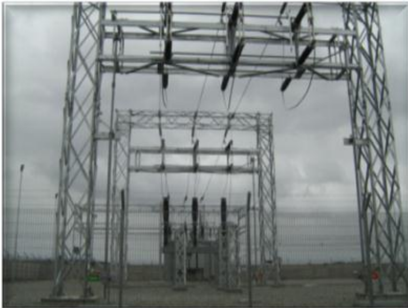
Proyecto: Subestación Calbuco Mandante: Saesa 2008
